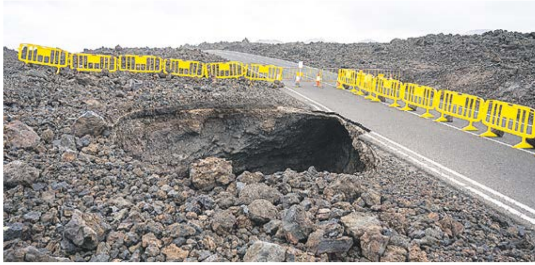
El principal socavón de la carretera.
