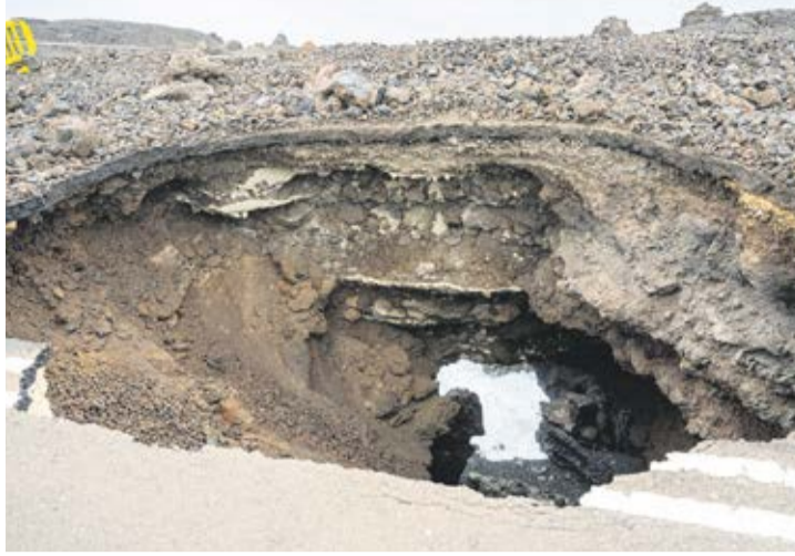
Gran socavón en la carretera. Foto: Adriel Perdomo.
