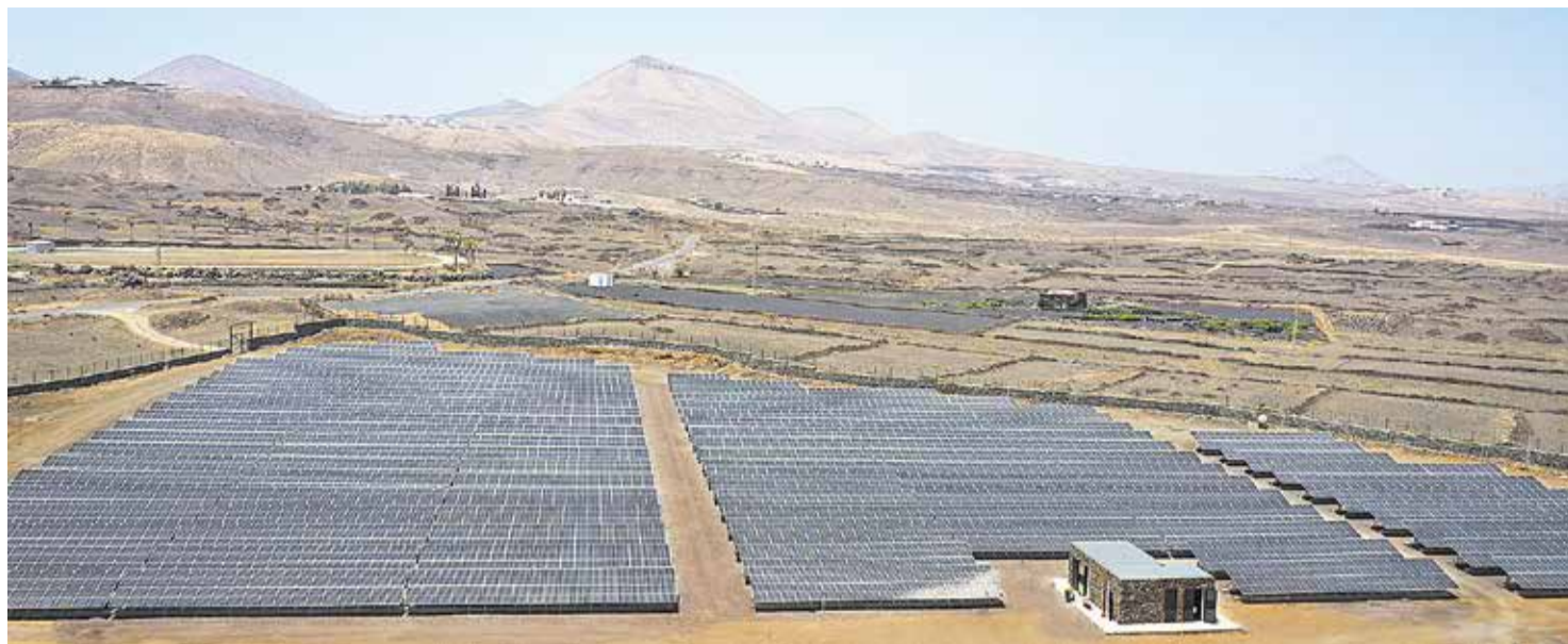
Planta fotovoltaica de autoconsumo.
