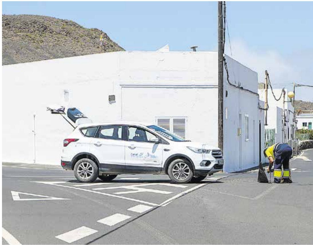
Un operario de Canal Gestión comprueba el suministro de agua.
