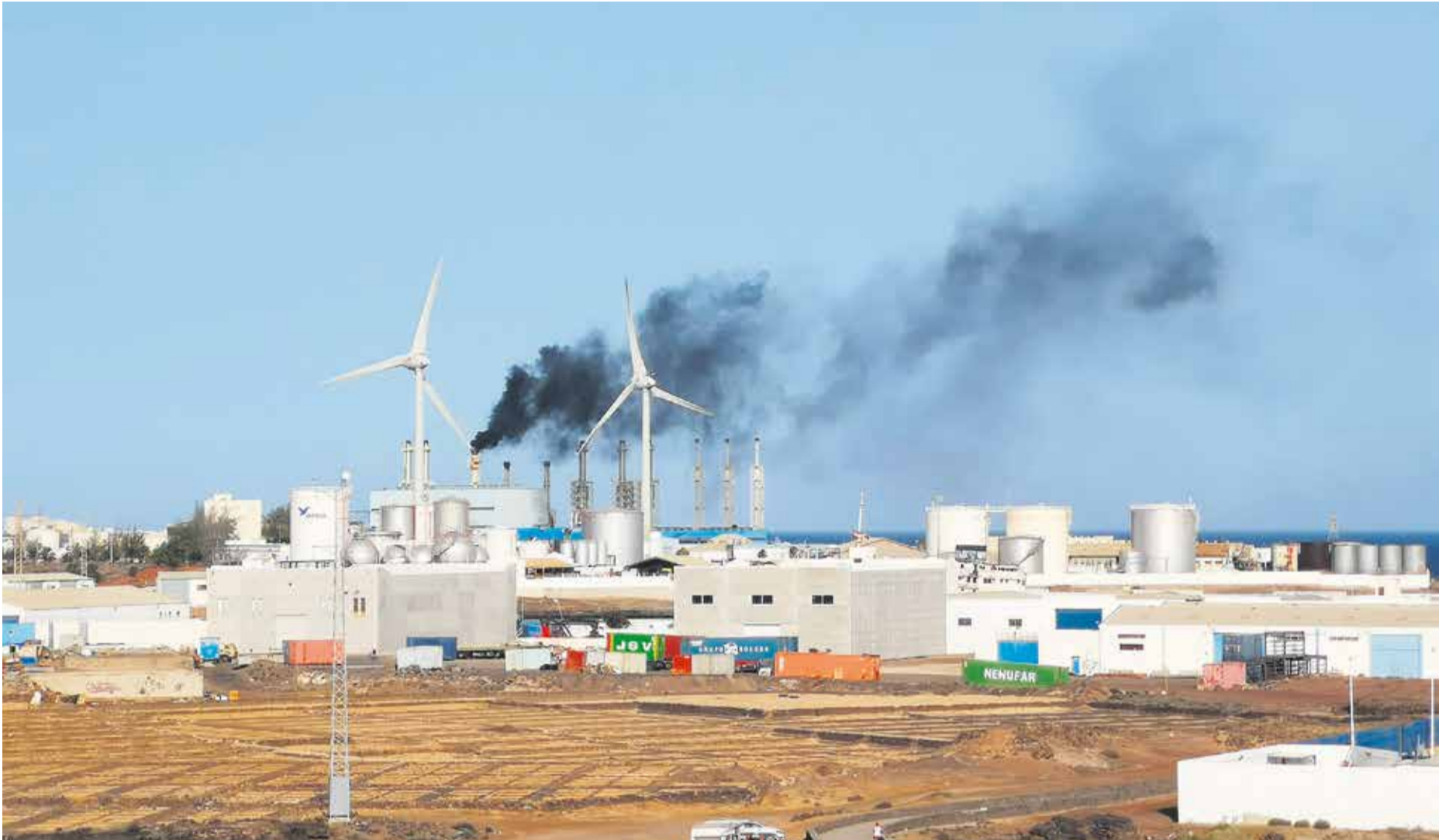
Central eléctrica en Las Caletas. Foto: Rafael Fuentes.
