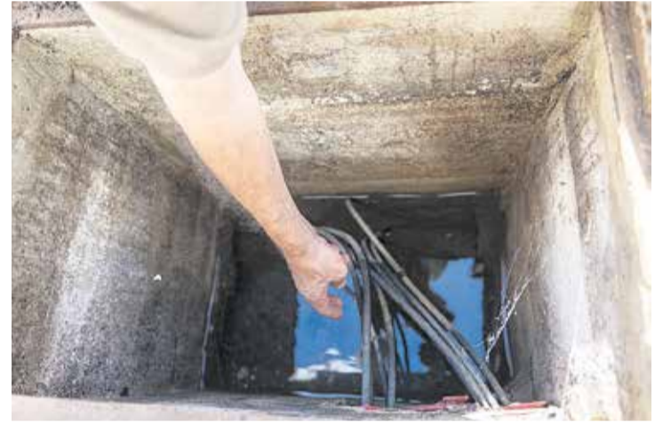
La arqueta de Endesa sigue llena de agua.
