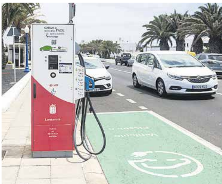
Punto de recarga en Arrieta.
