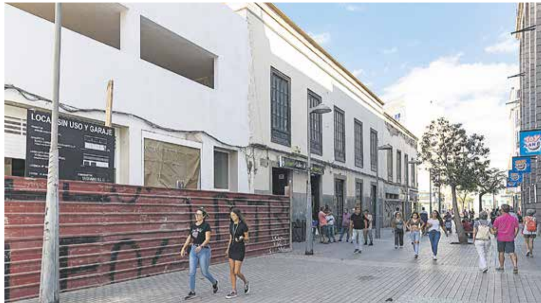
Nueva edificación en el solar que antes ocupaba una de las llamadas Casas Altas. Fotos: Adriel Perdomo.
