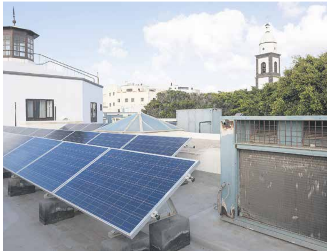
Placas solares instaladas en la azotea de la casa consistorial. Foto: Adriel Perdomo.
