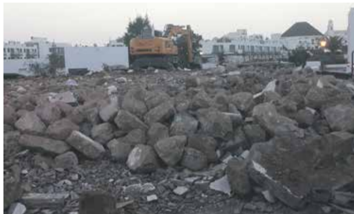
La casa de Santiago Medina ha sido derruida.
