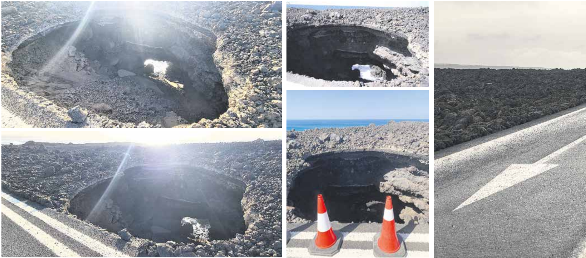
Varias imágenes del socavón junto a la carretera de Los Hervideros, producido por el oleaje. Fotos: Adriel Perdomo/Cedidas.
