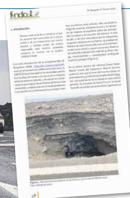
Estudio sobre el socavón.
