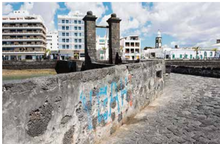
El uso de cemento Portland añadió más sales perjudiciales para la construcción.
