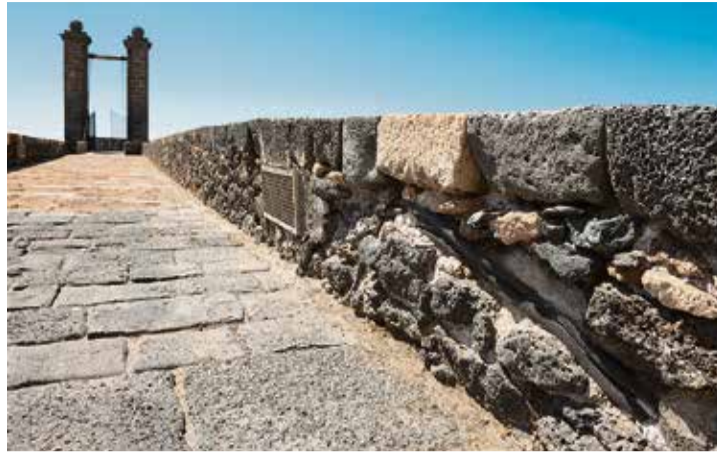
La colocación de tubos para la instalación eléctrica provocó daños en el pretil.
