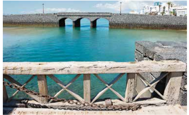
Puente de madera con problemas de carcoma desde 2003.
