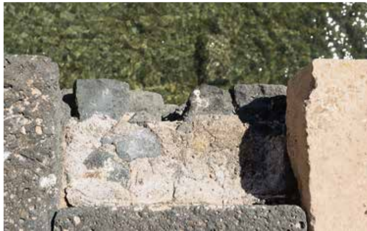
Hueco dejado por un sillar que se desprendió y cayó al agua.
